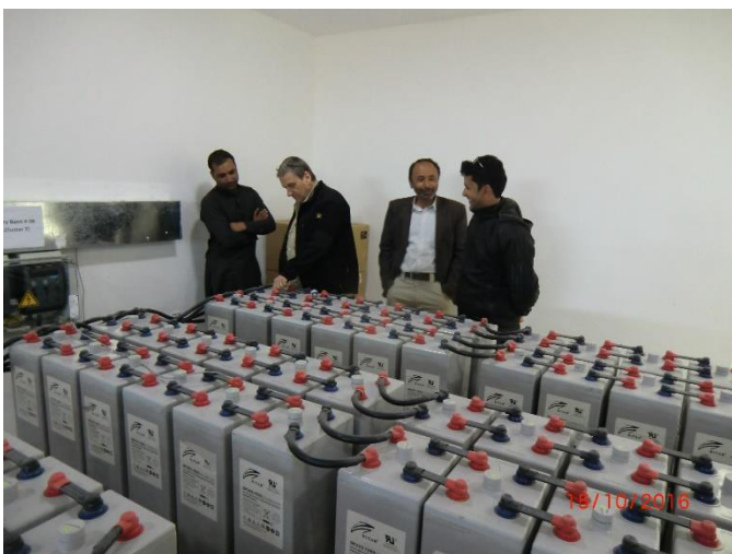
Batterien zur Energiespeicherung // Batteries for power storage
